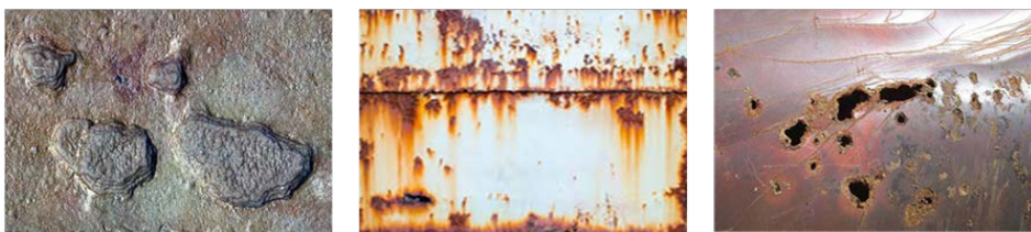
Figura 3 Coroziune în puncte, de tip cavernă (coroziune până la perforarea peretelui)
