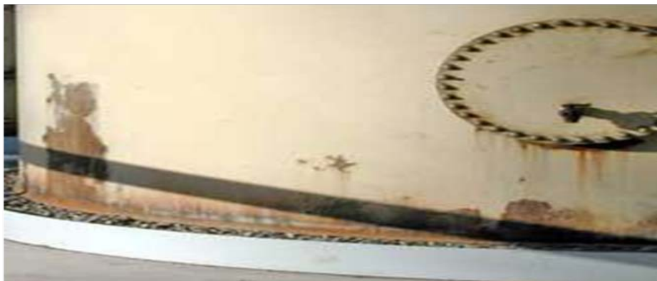
Figura 4 Coroziune în puncte la baza fundului rezervoarelor cilindrice
