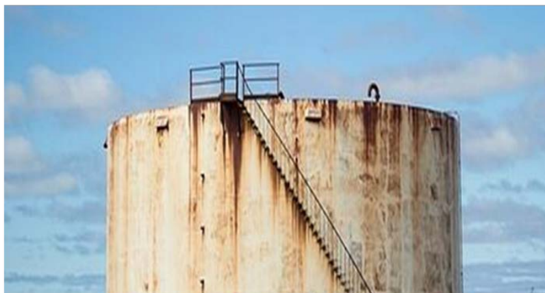
Figura 6 Coroziune la exterior a unui rezervor cilindric vertical suprateran
