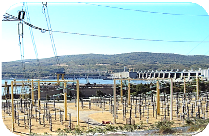
Fig. 13. Fotografia stației de 400 kV și a hidrocentralei Porțile de Fier 1.
